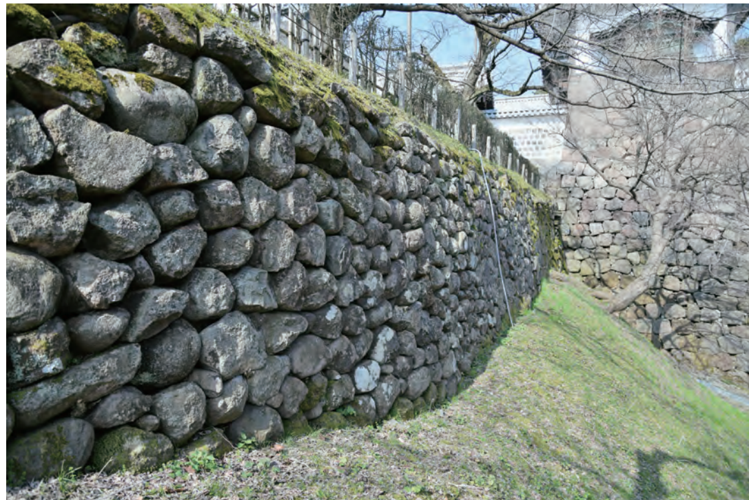
壁面が波打つように変形（地震以前）
