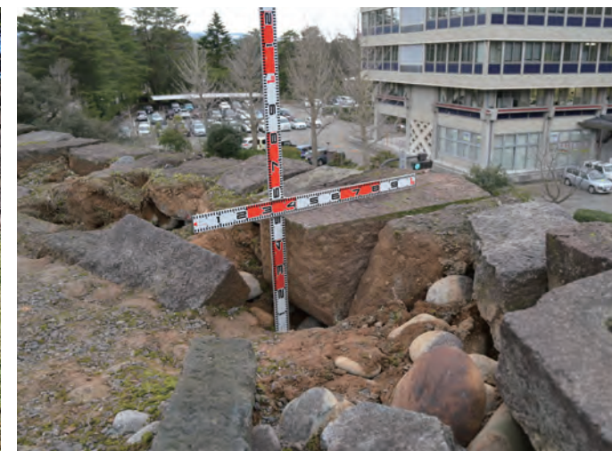
壁面の前倒れにより天端が上がり裏込めとの境に亀裂が生じた
