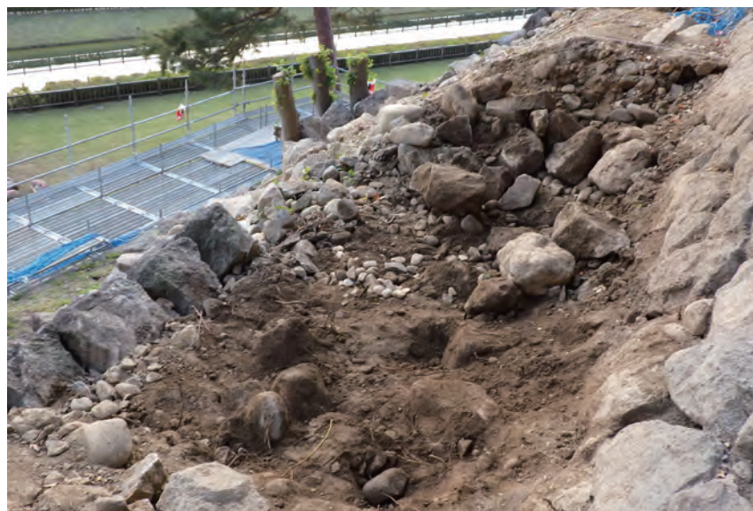
裏込めの土砂層に不要な旧材が浮石のように混在
