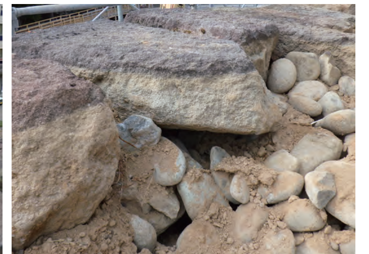
変形により築石周辺に詰められていた栗石との間に空隙が生じた
